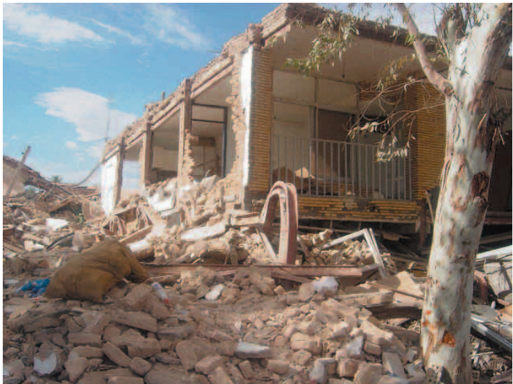
Bild 6: Gebäudezerstörung durch Erdbeben
