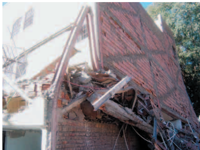
Bild 3: Versagen eines zu weichen Geschosses durch Erdbebeneinwirkung
