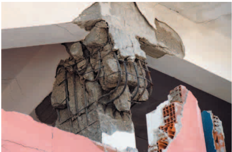
Bild 7: Schädigung durch „Effekt der kurzen Stützen“
