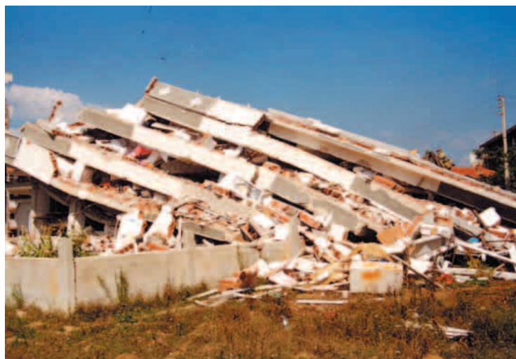
Bild 5: Durch versagendes Füllmauerwerk eingestürztes Gebäude
