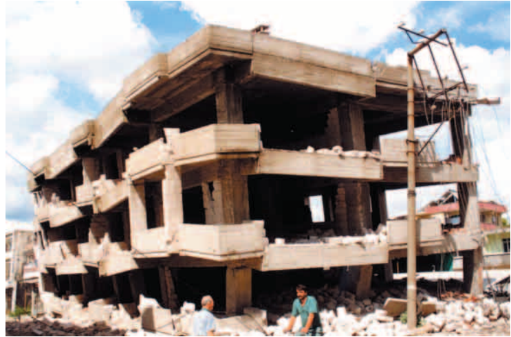
Bild 1: Gebäudeschäden durch Erdbeben
